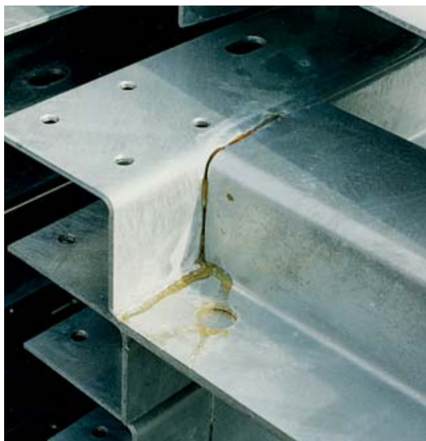
Obr. 7-11 – Kyselina zadržaná ve spáře. Kyselina a soli železa proleptaly otvor v zinkové vrstvě, vytékají korozní produkty.
