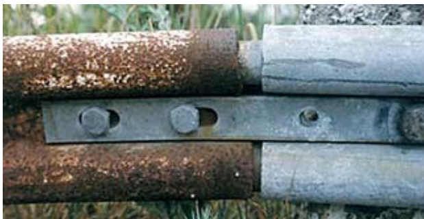
Obr. 1-1 – Nalevo je korodující svodidlo opatřené nátěrem. Pro porovnání je vpravo svodidlo žárově zinkované.
