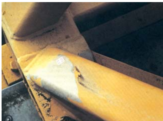
Obr. 11-3 – Odlupování vrstvy nátěru dané špatnou přípravou před provedením nátěru (22).
